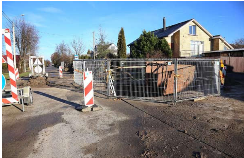
Elektros kabelių tiesiančios įmonės pažeisti vandentiekio tinklai ne tik pablogino vandens kokybę, paliko dalį gyventojų be vandens, bet ir išplovė gruntą po sankryža.
